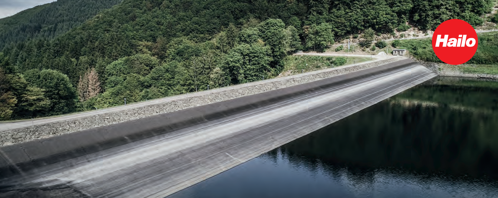
Talsperre (Trier), GLOBALlift im Schieberschacht, 50 m tief
