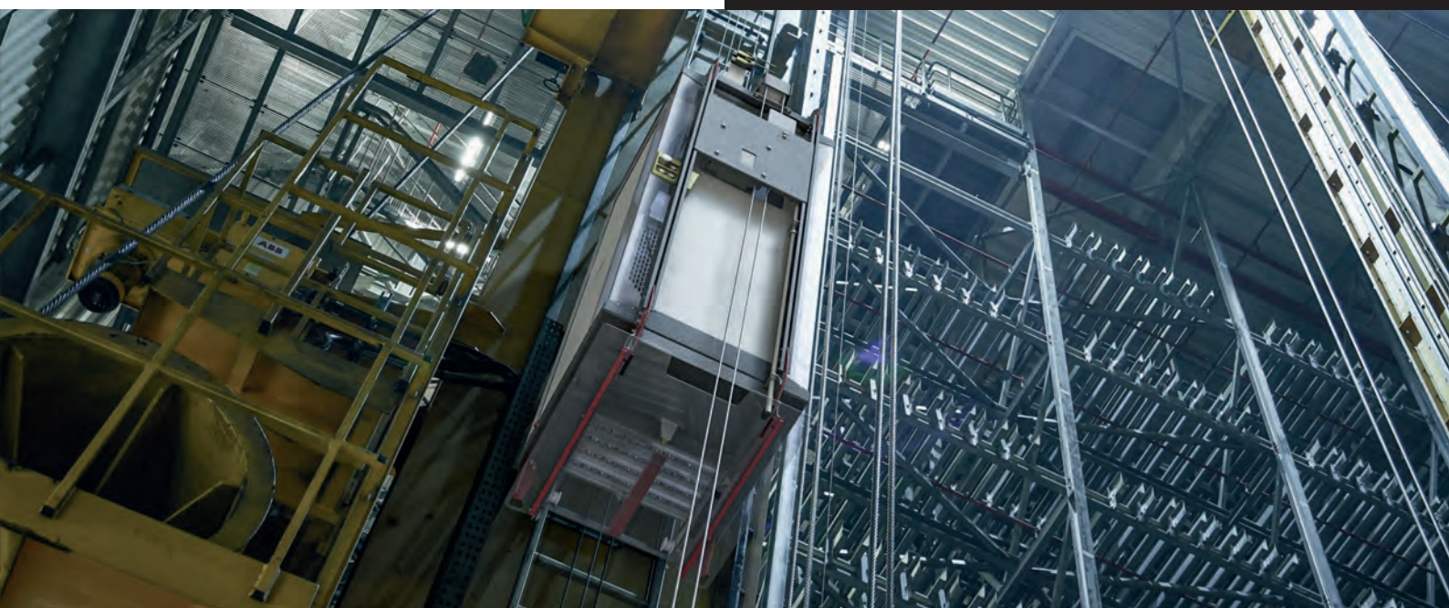
Hochregallager (Frankfurt), TOPlift, 40 m Fahrstrecke
